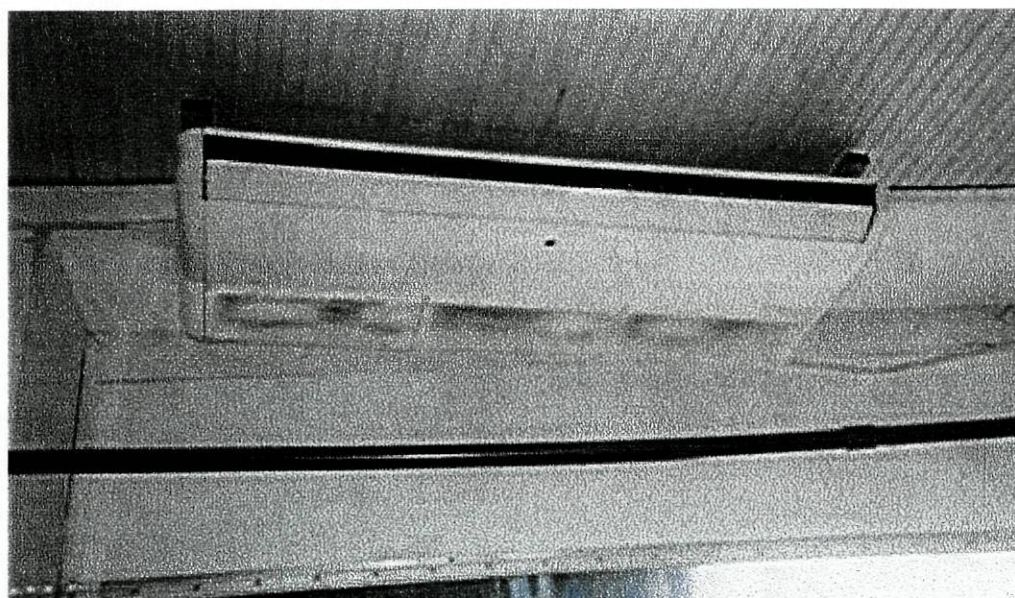
Figura 41 - Aparelho de ar condicionado do centro de expedição
