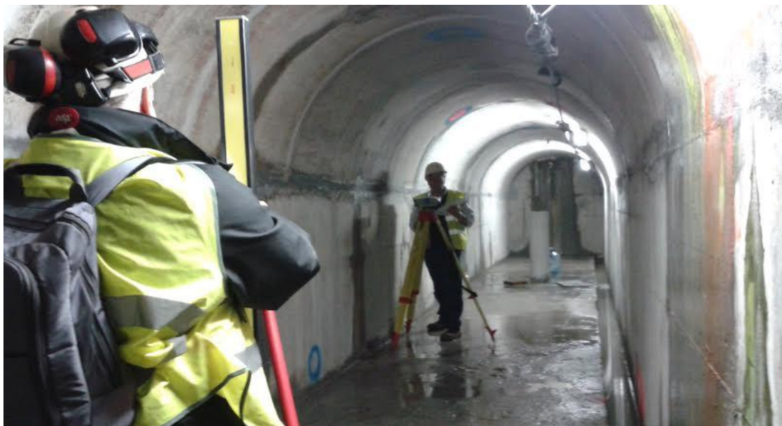
Figura 29 - Exemplo de galeria de visita em fase final de construção na barragem de Foz Tua
