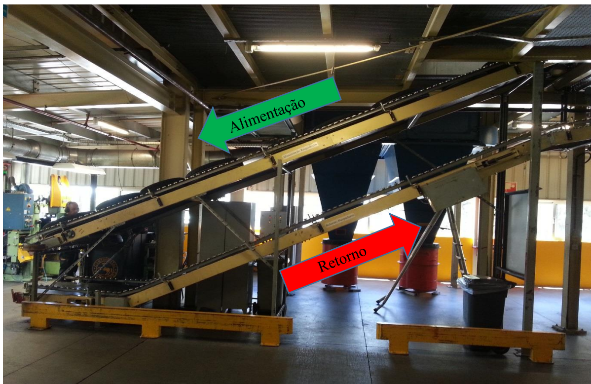
Figura 49 – Passadeiras de alimentação e retorno de pneus na zona de raspagem
