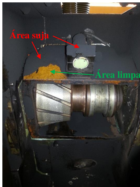
Figura 76 – Sujidade na máquina de raspagem
