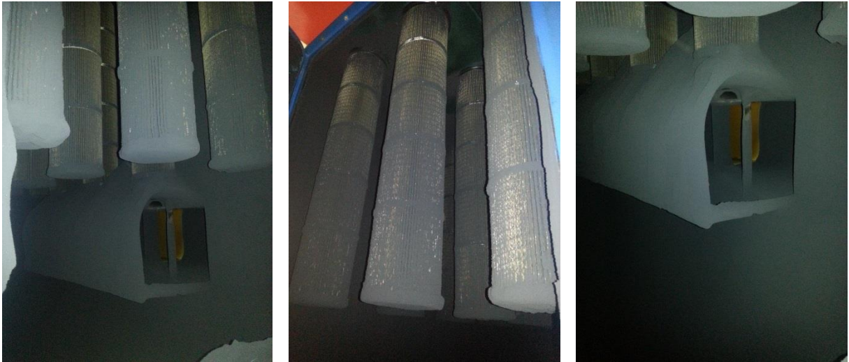
Figura 75 – Estado do ventilador e filtros no interior
