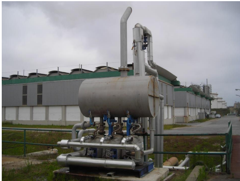
Figura 9 - Recuperador de condensados gerados na linha de VMP para geração de VBP.
