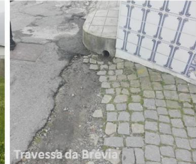
Fig. 4 Pavimento em mau estado
