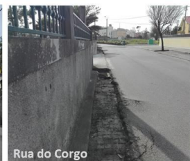
Fig. 4 Passeio em mau estado
