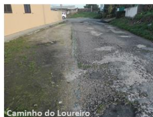
Fig. 5 Pavimento em mau estado de conservação
