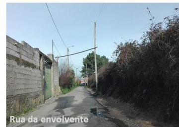
Fig. 12 Pavimento em mau estado de conservação
