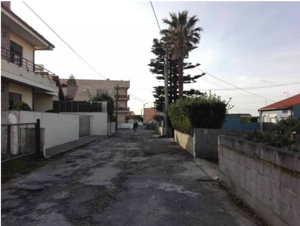
Figura 53: Notável mau estado de conservação do pavimento
