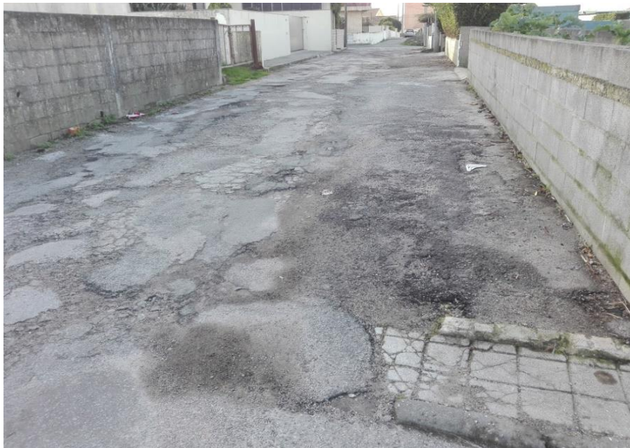
Figura 55: Ausência de passeio e rua em mau estado
