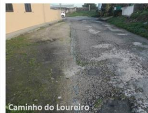
Fig. 5 Pavimento em mau estado de conservação
