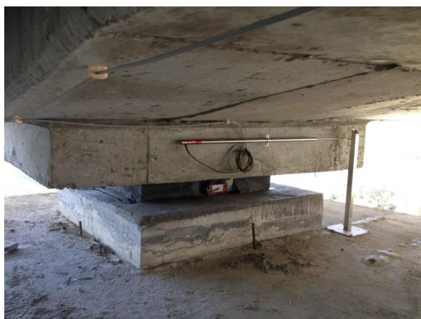
Fig. 4. 2 – Exemplo de um transdutor de deslocamentos do tipo LVDT instalado em obra (LABEST/FEUP e NewMENSUS 2014).
