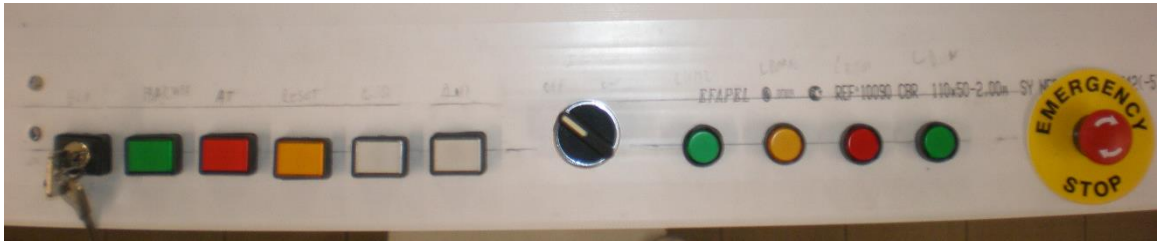
Figura 97 – Fotografia do painel de comando e monitorização
