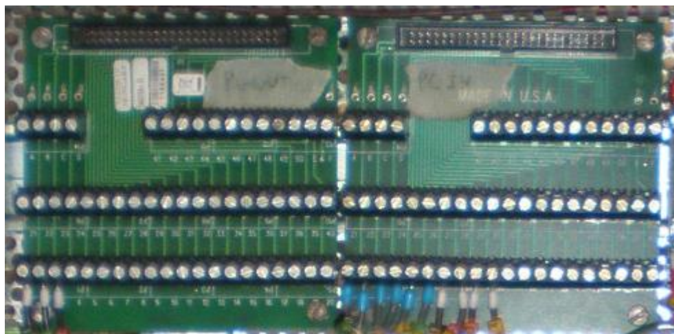
Figura 83 – Fotografia das duas placas de terminais
