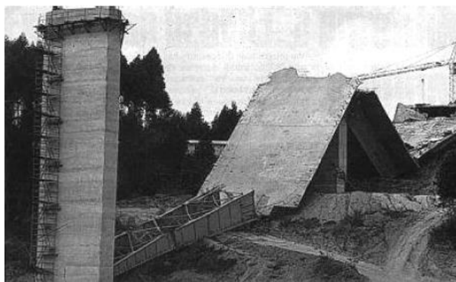
Fig. 2.14 – Colapso da ponte Injaka , 1988, falta de controlo no processo construtivo [4]
