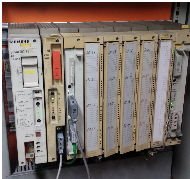
Figura 5.1: Autómato SIMATIC S5 a substituir
