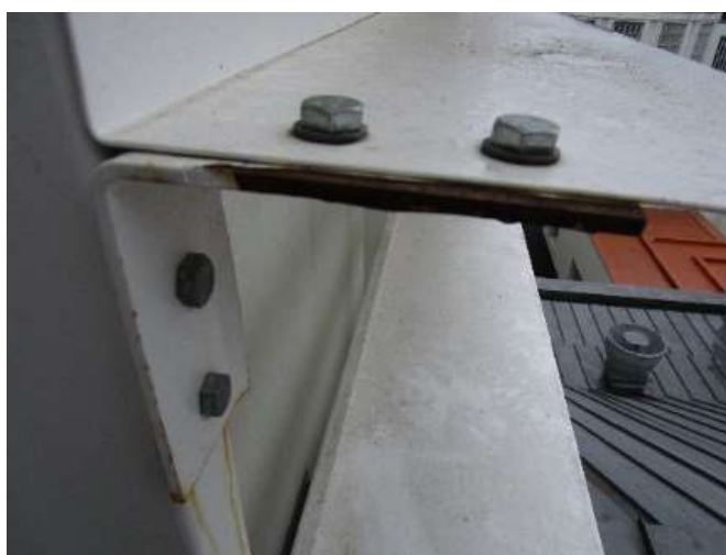
Fig. 58 – Corrosão numa lâmina de ferro.
