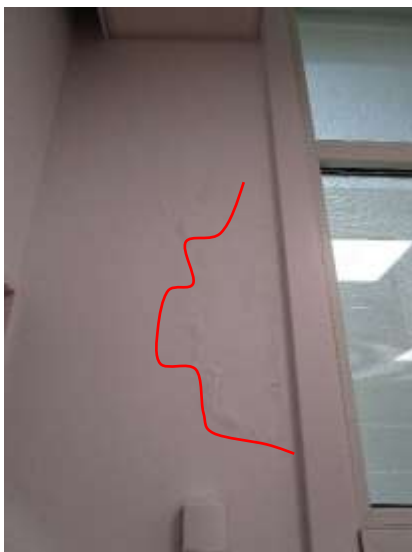
Fig. 48 – Humidade na parede da sala L.1.11.
