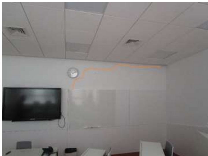
Fig. 53 – Fissura na zona do relógio.
