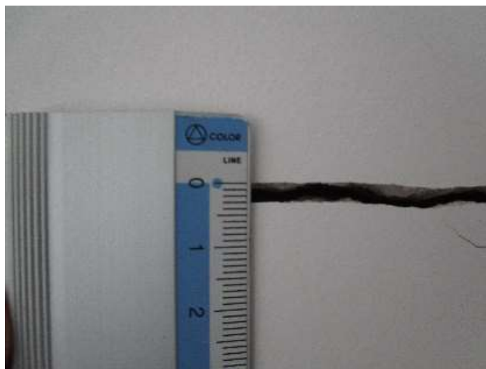
Fig. 56 – Medição da abertura da fissura.
