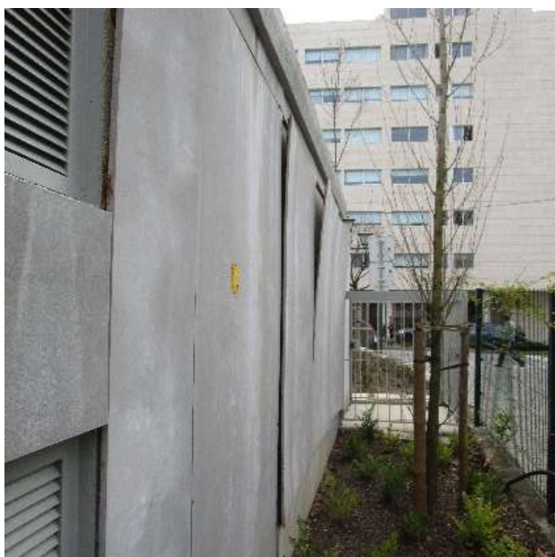
Fig. 46– Viroc no compartimento dos geradores.
