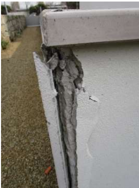
Fig. 44 – Fratura do reboco no muro exterior.
