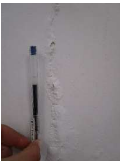
Fig. 49 – Tipo de manchas de humidade na parede da sala L.1.11.
