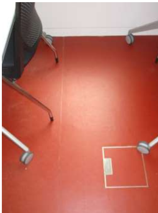
Fig. 65 – Empolamento do linóleo no piso 1 na sala de exame L.1.12.
