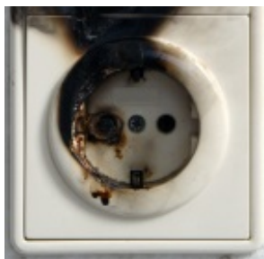
Figura 3.3: Tomada queimada por arco elétrico devido a mau contacto elétrico
