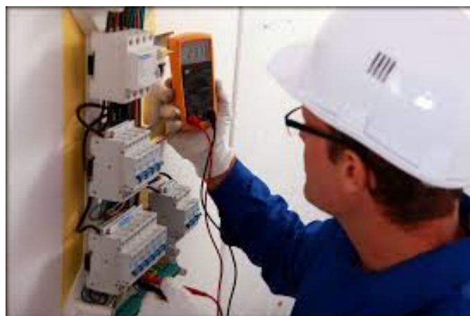
Figura 4.1: Técnico Responsável verificando um quadro elétrico
