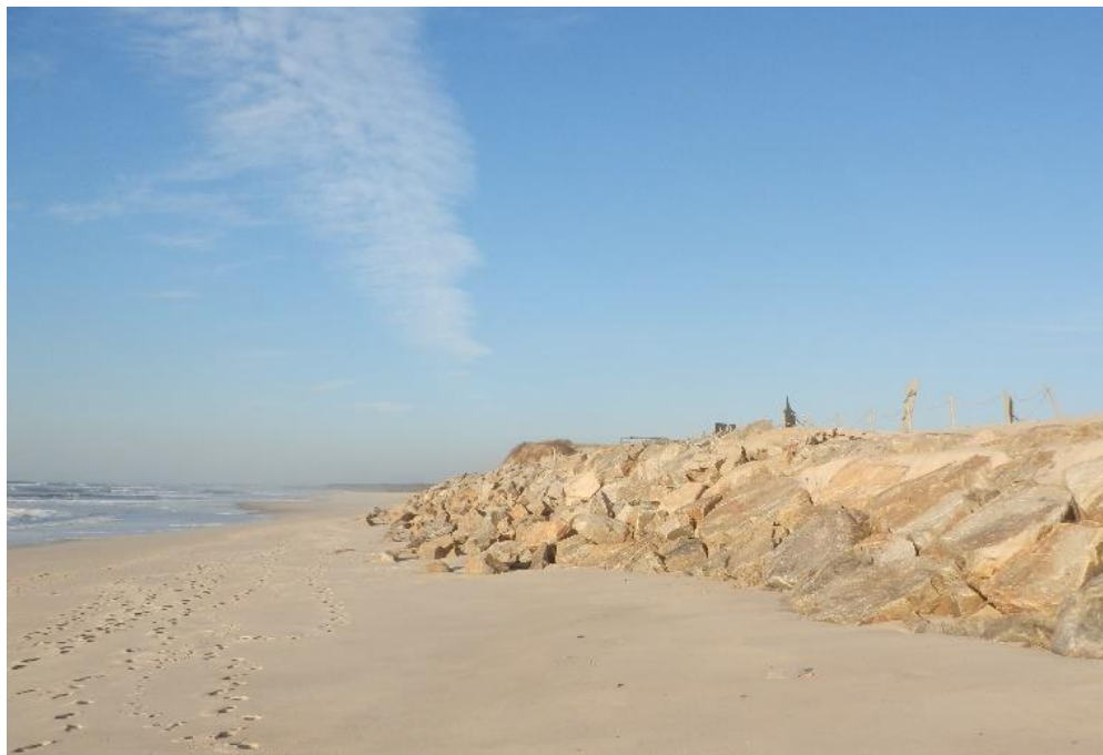
Figura 4.25 - Parte da estrutura aderente norte destruída.
