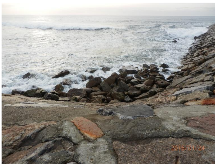
Figura 4.31 - Pedras soltas na base do esporão norte.
