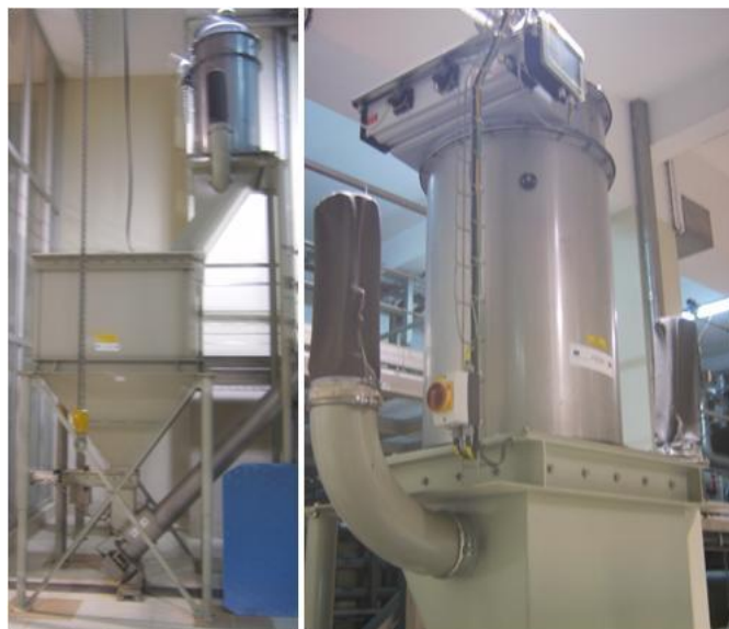
Figura 21. Tanque de armazenamento de cevada (esquerda) e sistema de aspiração de ar com filtros de poeiras (direita).
