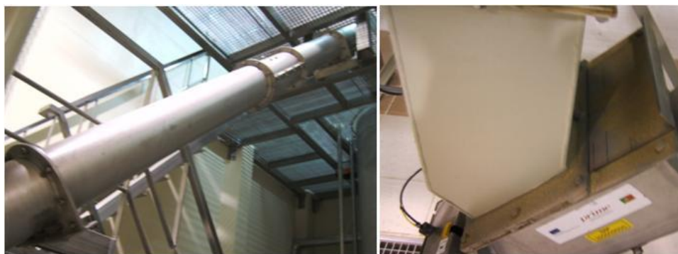
Figura 22. Transportador parafuso de cevada para o tanque de molha (esquerda) e chapa sob o tanque de armazenamento de cevada (direita).
