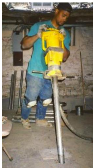
Figura 2.38 - Manobrador a utilizar o equipamento da técnica de Compaction grouting (Dias Pereira, 2008)
