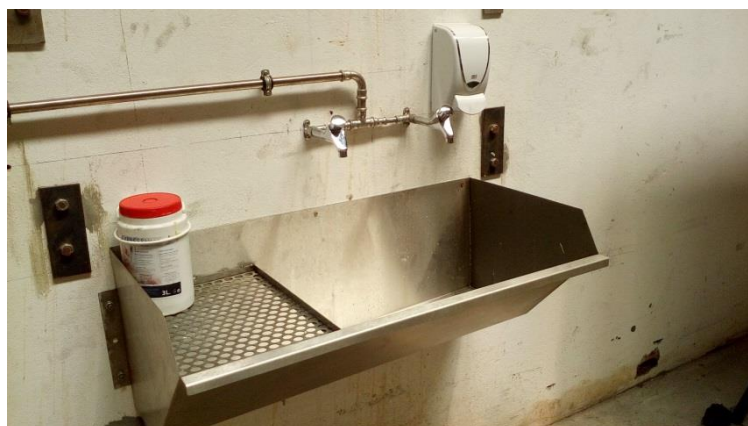
Figura 40 – Lavatório instalado na ACR
