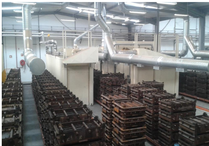
Figura 25 - Estufas e linhas de refrigeração
