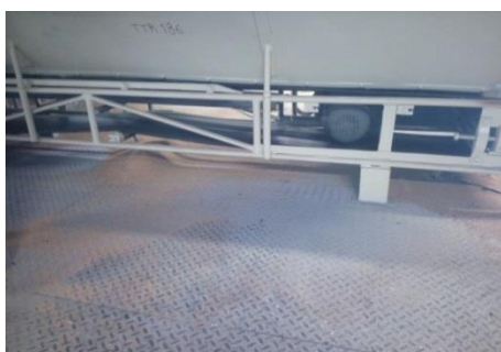
Figura 20- Queda de material do tapete transportador de granulado
