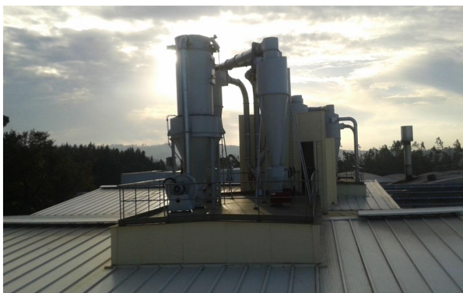
Figura 3- Ciclones e ciclo filtro (Exterior do edifício)
