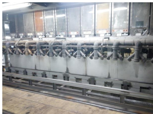
Figura 10- Doseadores automáticos (Piso 2)
