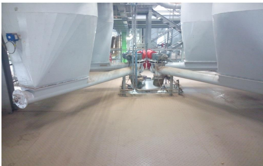
Figura 4 – Mini silos (Piso 4)
