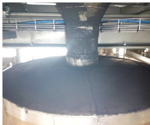
Figura 35 - Readaptação da manga de encaminhamento do negro de fumo
