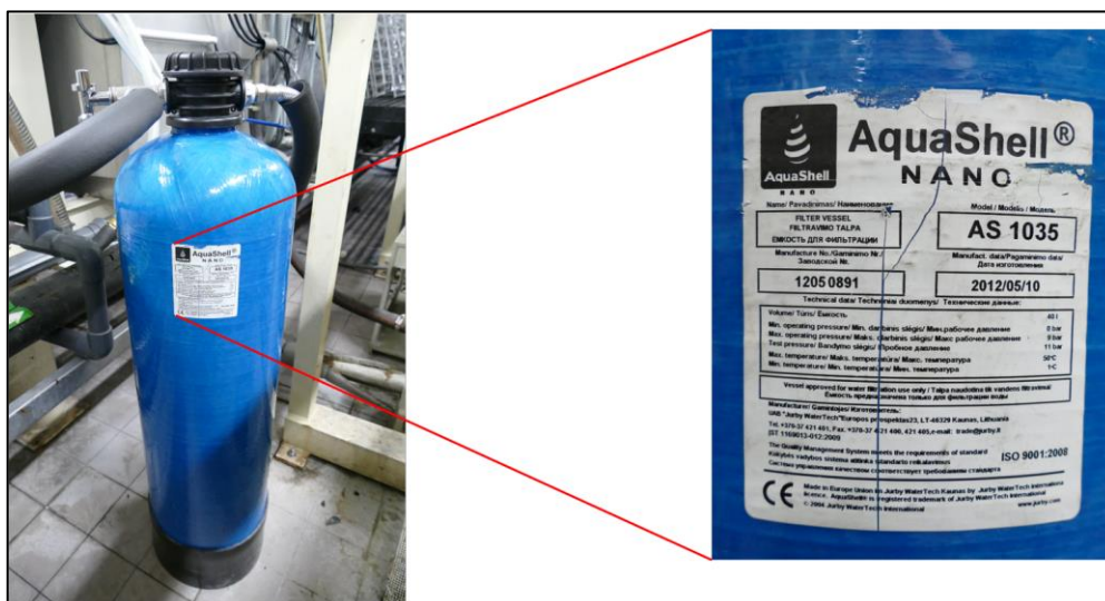
Figura 14 - Coluna de resina de leito misto pela qual passa a água desmineralizada que abastece as tinas de lavagem que antecedem o processo de colmatagem e as tinas de colmatagem.
