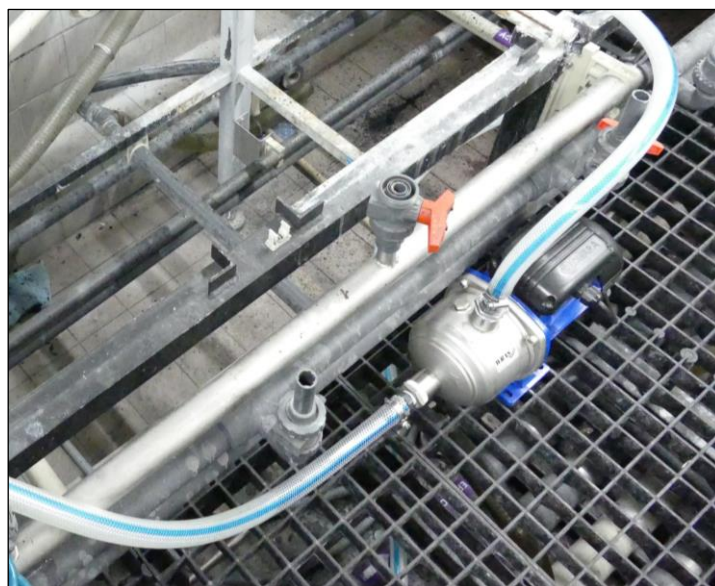
Figura 22 - Bomba destinada à circulação do banho da tina A-24.
