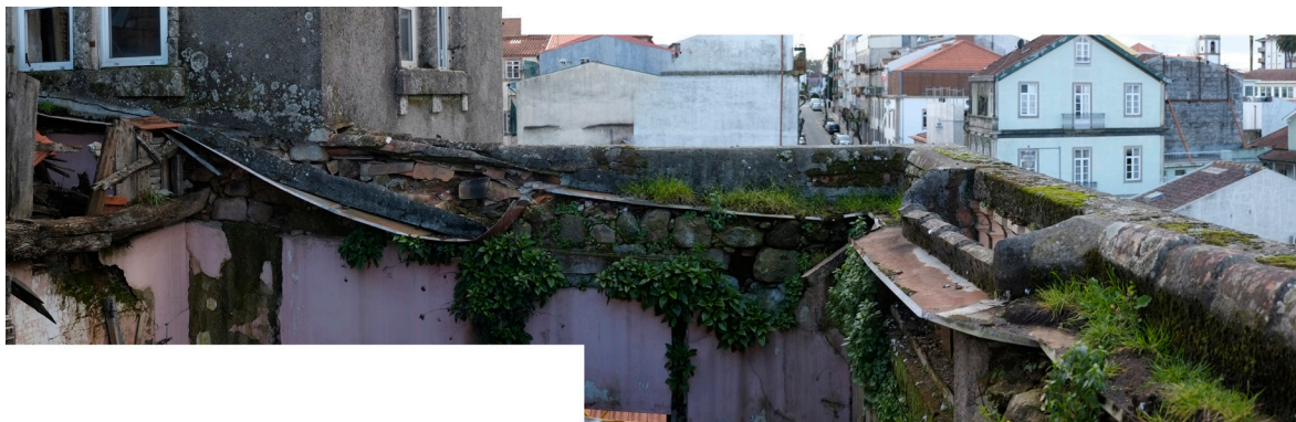
Fig.211 Cobertura do compartimento 5 desabada
