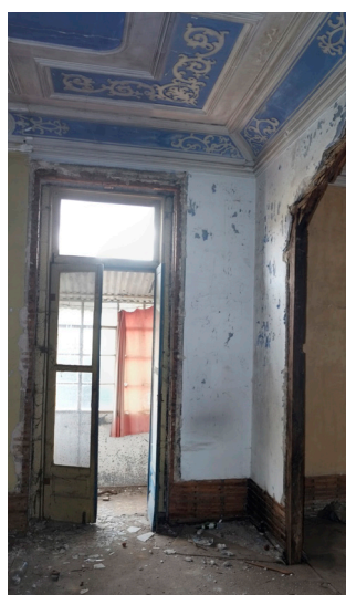
Fig.177 (6) Danos na pintura
