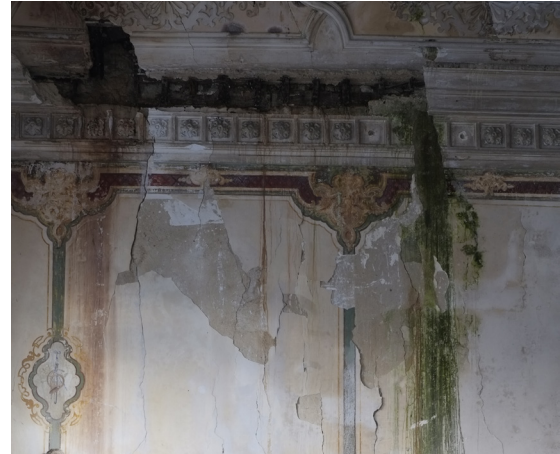
Fig.162 Danos derivados de infiltrações
