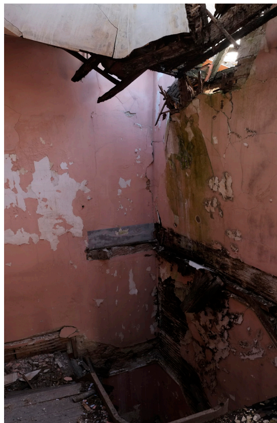
Fig.146 Cobertura e escadas colapsadas
