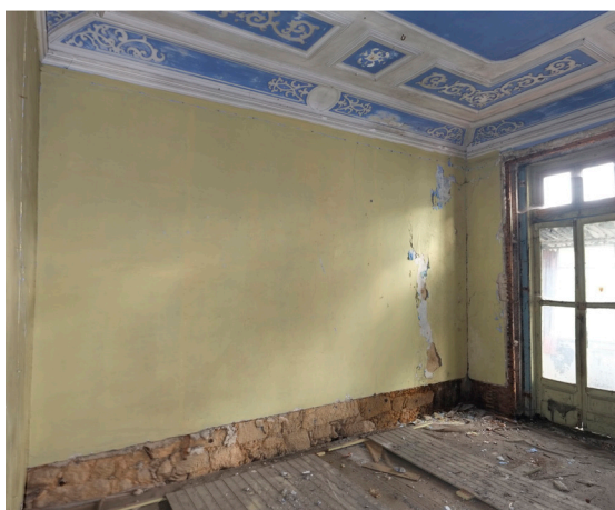
Fig.175 (6) Infiltrações na parede de meação
