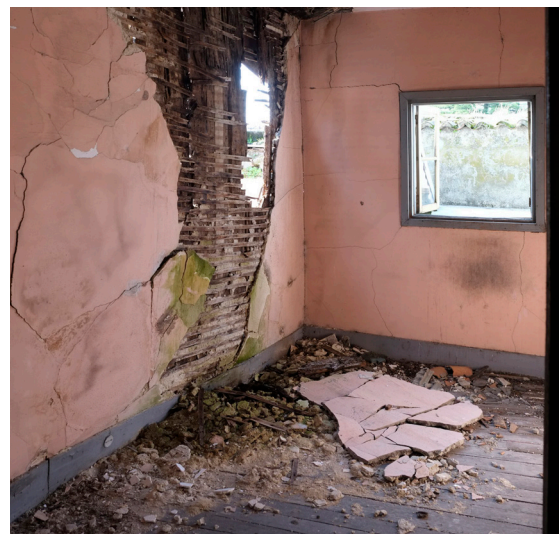
Fig.193 Danos estruturais na parede de tabique
