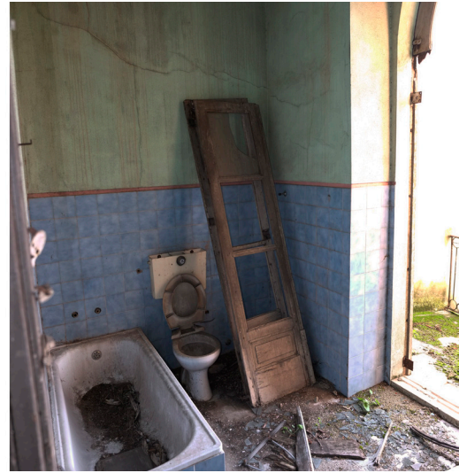
Fig.179 Acumulação de lixo no sanitário
