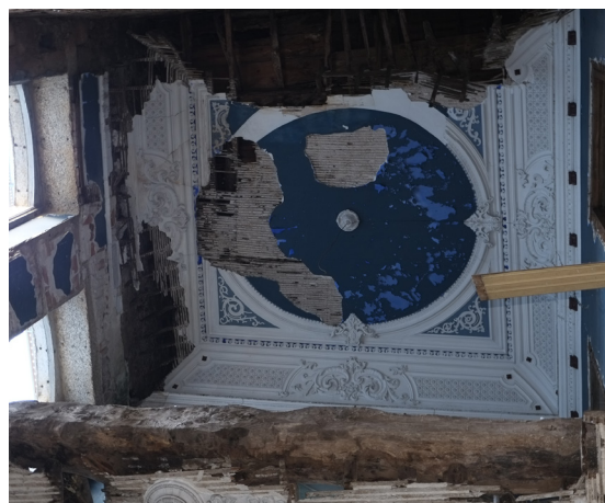
Fig.168 Danos no contacto do tecto com as fachadas
