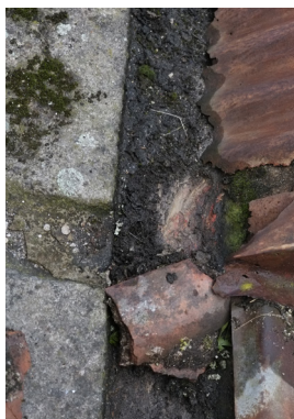
Fig.208 Acumulação de lama na caleira
