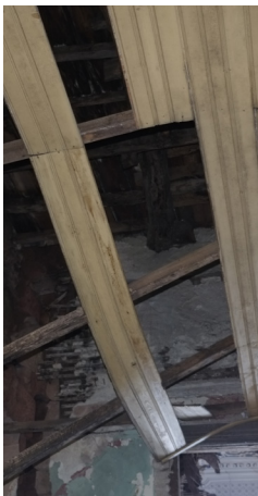
Fig.171 Tecto falso e sobrado em risco de queda
