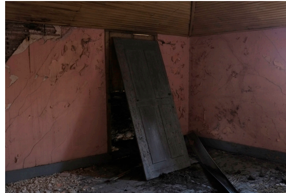
Fig.192 Fissurações e danos no filme de pintura
