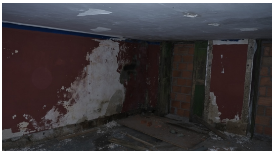
Fig.142 Danos derivados de infiltrações na parede de meação
