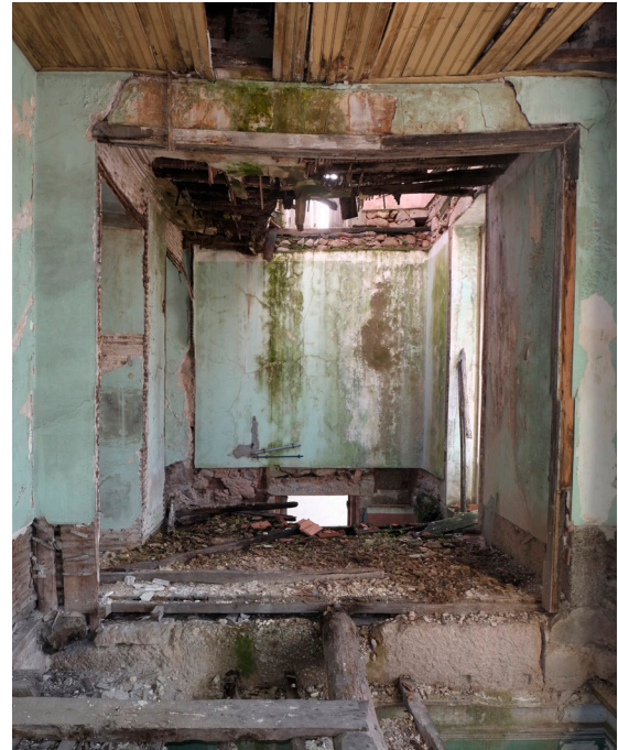
Fig.169 Abaulamento do tecto na passagem para a sala seguinte
