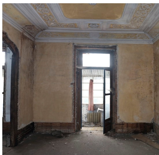
Fig.178 (5) Infiltrações na parede divisória dos compartimentos (esq.) e na da torre (dir.)
