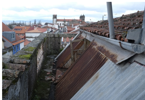
Fig.210 Degradação dos revestimentos
