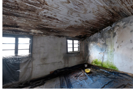
Fig.191 Infiltrações na cobertura e parede de meiação
