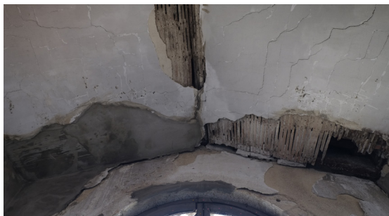
Fig. 189 Danos no tecto devido o abaulamento da cobertura
