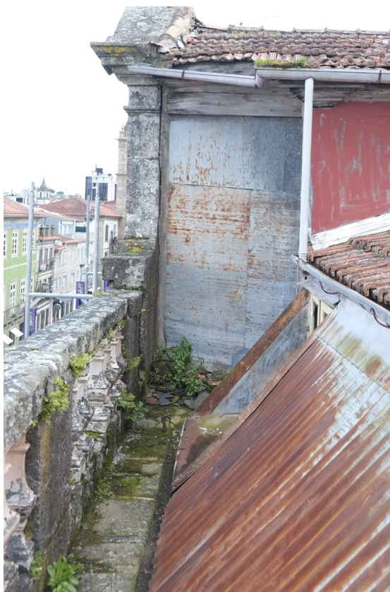
Fig.206 Deformação na cobertura
