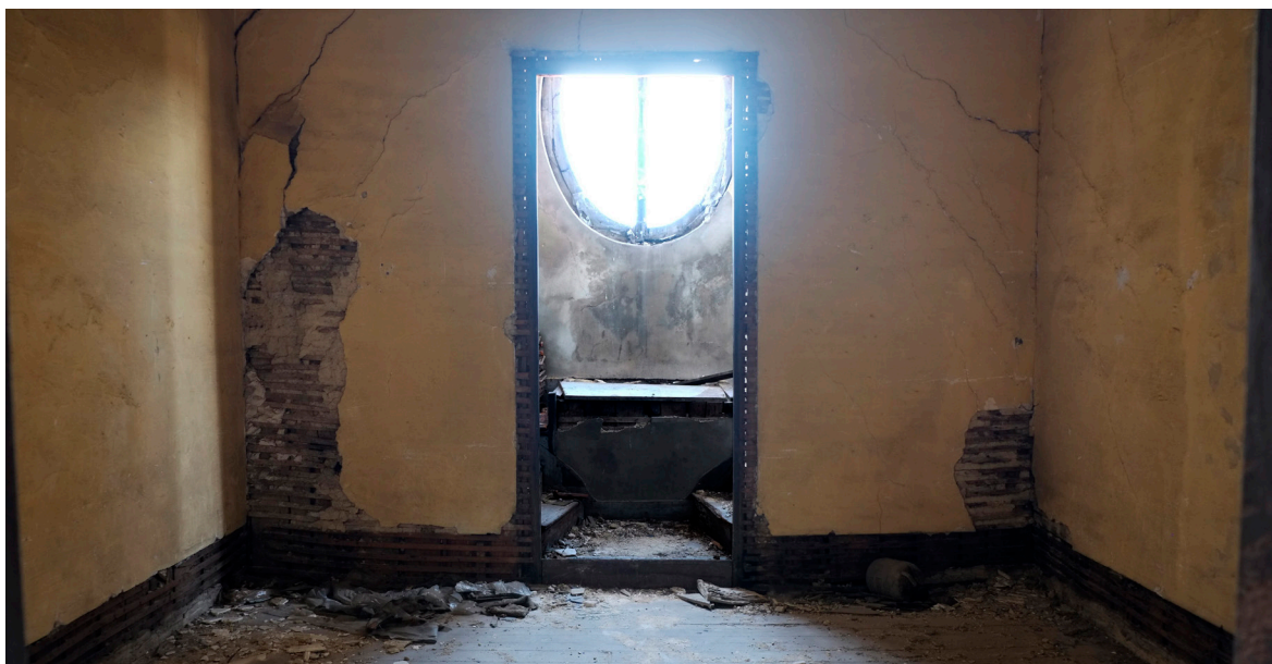
Fig. 190 Danos e fissurações nas paredes devido ao abaulamento da cobertura
