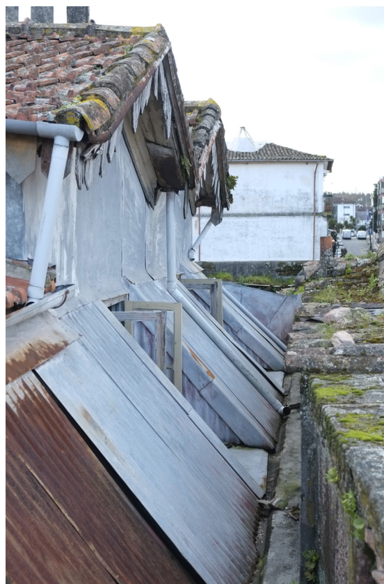
Fig.207 Insuficiência de escoamento
