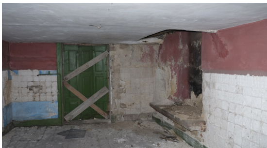
Fig.143 Danos derivados de infiltrações e remoção de revestimento interior
