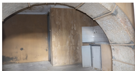
Fig.145 Eflorescências e danos no filme de pintura
