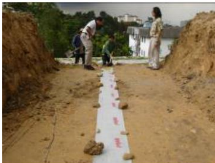
Figura 2.47 – Monitorização de um talude: a) esquema de aplicação; b) instalação do geotêxtil na trincheira situado no topo do talude. (Loke et al. , 2006)
