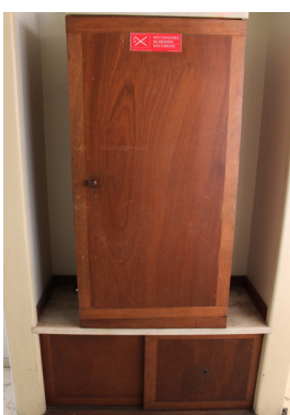
Quadro elétrico 1 (M6)
