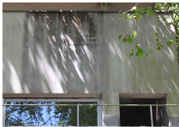
Figura39. Manchas de colonização biológica.
