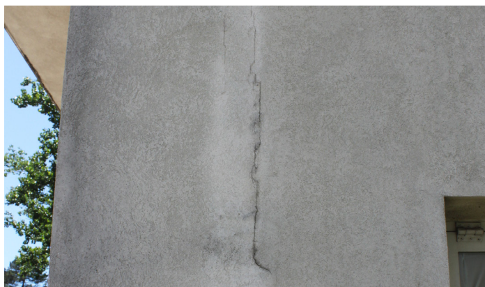
Figura38. Fissurações nas juntas das placas de isolamento.
