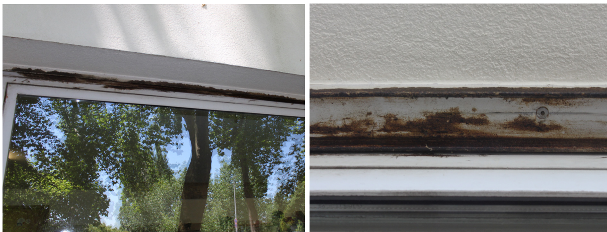
Figura41. Corrosão das caixilhariás.
