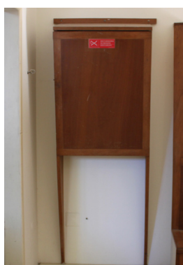
Quadro elétrico 2 (M6)
