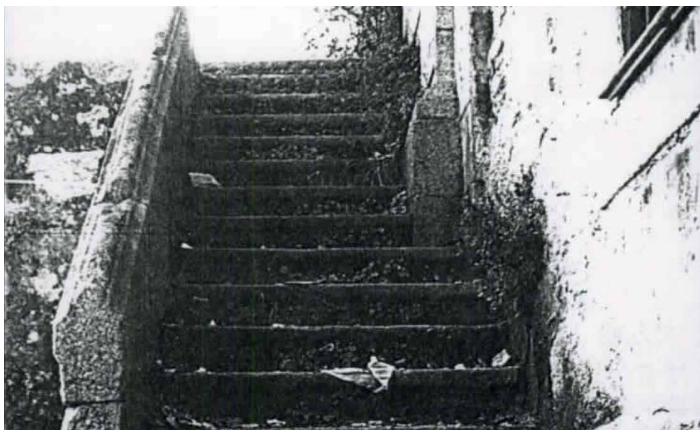
Figura 110 - Escada de acesso à capela, com parapeito rematado com perfil adaptado à mão. Apesar de faltarem pedras neste elemento e no patamar superior da capela, estas eram visíveis nos terrenos, a servir de muretes, o que possibilitaria a sua reposição.
