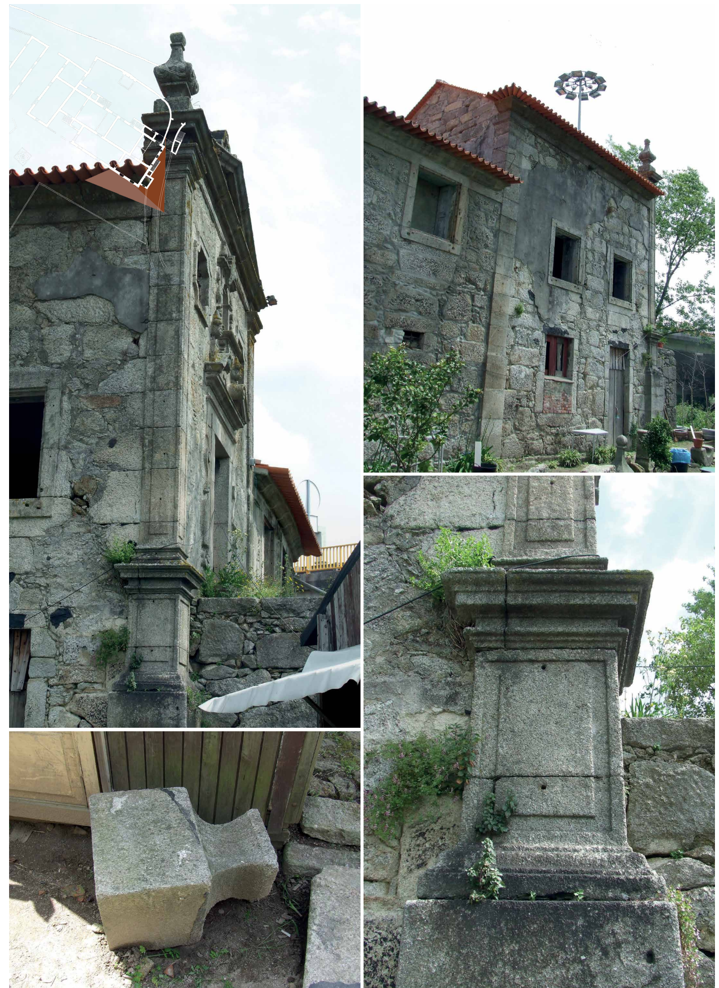
Figuras 510-513 - Como já referido, a cobertura da capela foi reconstruída sem os elementos que a constituíam. Contudo, nas suas imediações ainda existem várias peças danificadas que, notoriamente, terão pertencido à sua estrutura.
