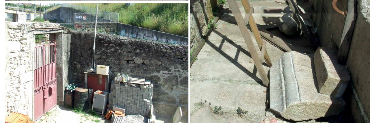
Figuras 554-556 - Após subir a escadaria Nascente, observa-se a existência uma parte de cornija pousada sobre o patamar e os pilares encontram-se grampeados aquando da recuperação da casa.
