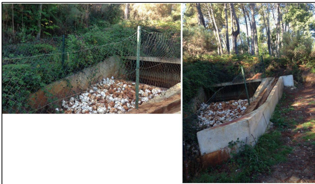
Figura 19. Escadas de arejamento do sistema de tratamento passivo da Mina de Jales
