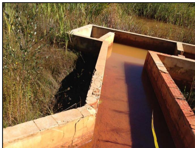
Figura 21. Escoamento da água ácida para a wetland 1 através do dreno com calcário
