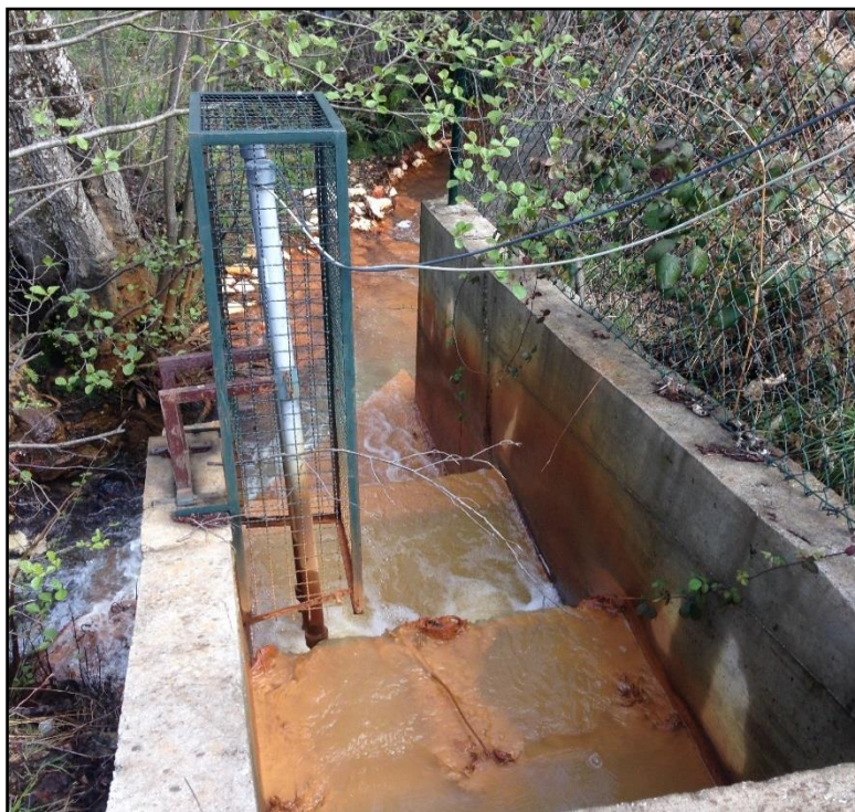
Figura 31. Ponto de descarga para a Ribeira de Peliteira da água tratada da mina de Jales, local onde esta fixado o medidor de pH
