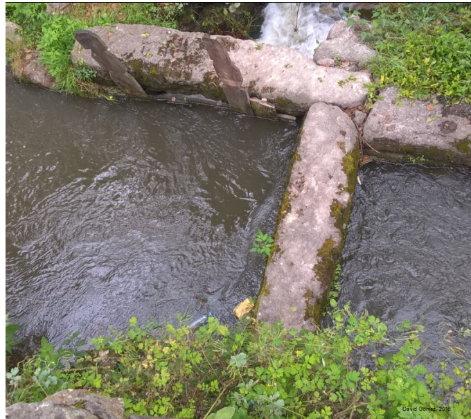
Figura 5.9: Ponto de descarga e de regularização de caudal.
