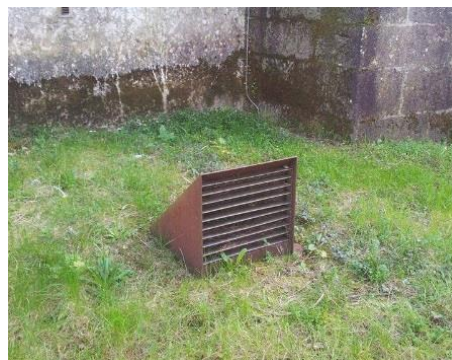
Figura 7 - Pormenor da grelha de admissão e extração de ar para a ventilação natural presente no exterior do Mosteiro de Vilar de Frades.
