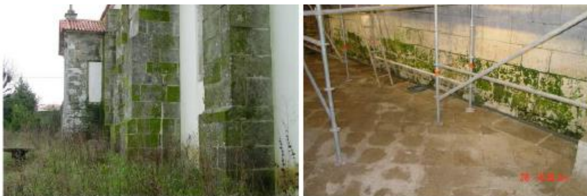
Figura 15 - Estado de conservação das paredes do edifício antes do início do tratamento [8].
