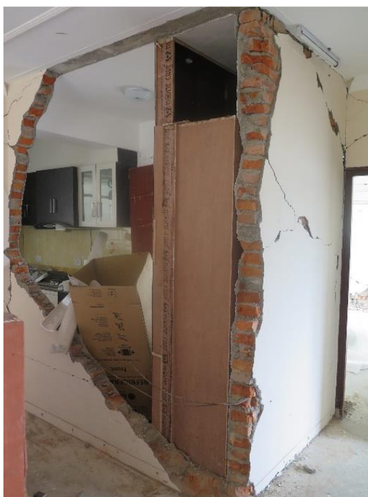
Figura 3.23 – Exemplo fotográfico do colapso para fora do plano de um painel de alvenaria
