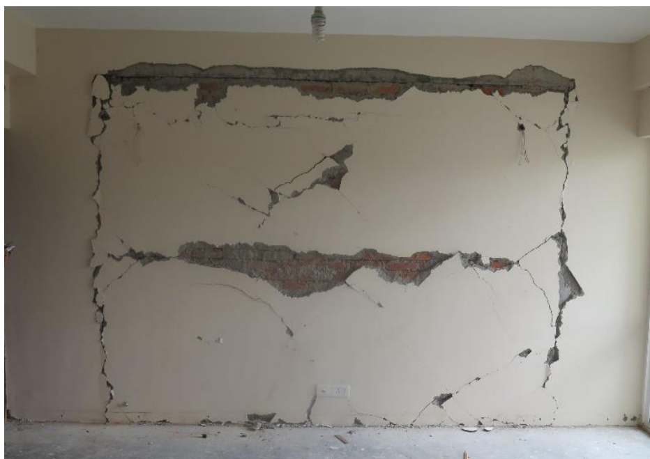
Figura 3.21 – Exemplo fotográfico da rotura de um painel no próprio plano com aparecimento de fissuração por corte combinada com o deslizamento a meia altura do painel
