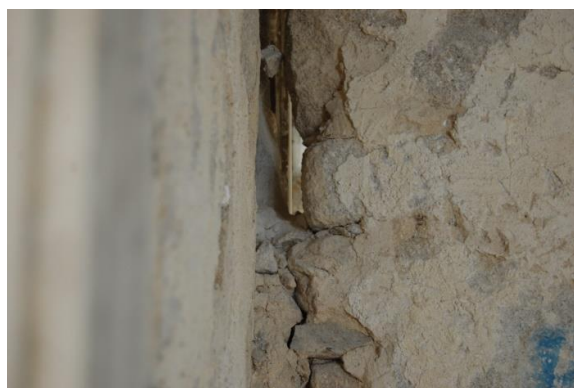
Fig. 3.23 - Falta de ligação entre as paredes B e C
