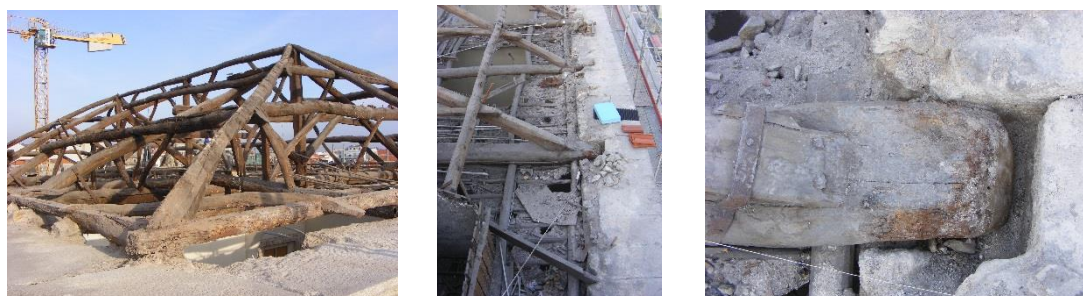
Fig. 3.28 – À esquerda: Cobertura da Torre Sul degradada; ao centro: apoio das asnas na parede de fachada; à direita: apoio da asna e ligação entre perna e linha
