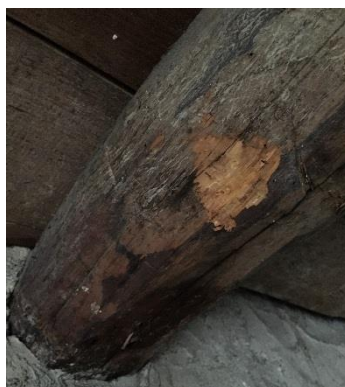
Fig. 4.3 – Pequeno corte numa viga para inspeção visual da zona não degradada
