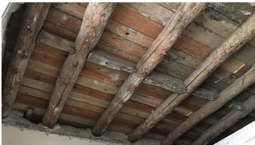
Fig. 4.4 – Vista inferior do pavimento em estudo; deteção de defeitos
