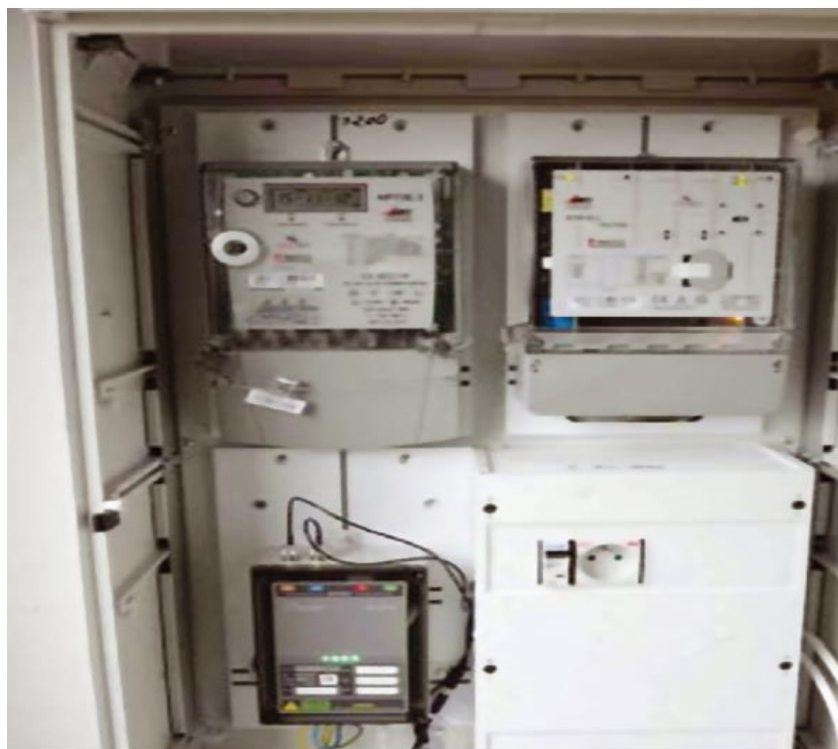
Figura 5.3 - Cabine instalada num transformador MT/BT numa subestação [46]
