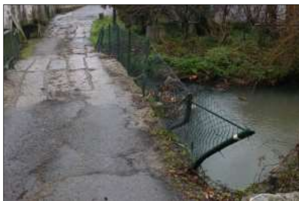
Figura 6.4: Ponte degradada existente no local C.
