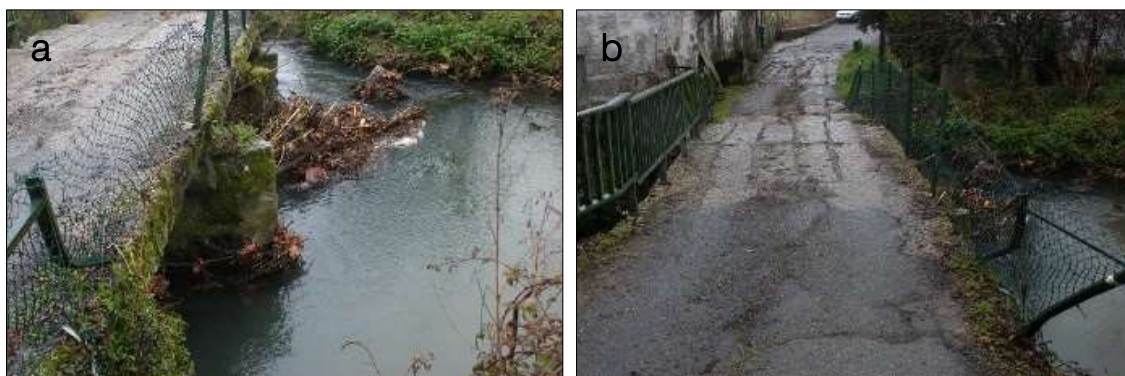
Figura 5.20: Fotografias tiradas no local onde se situa a ponte degradada.
