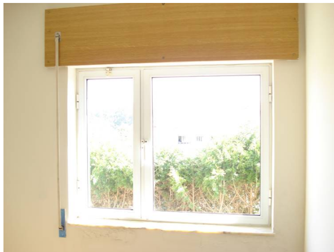
Fig. 24 - Janela sem selagem.
