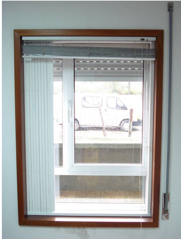
Fig. 31 - Janela com sistema de segurança.
