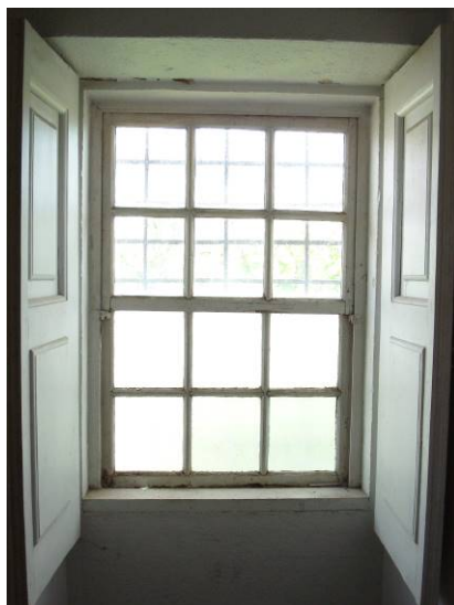
Fig. 27 - Janela de guilhotina muito degradada.
