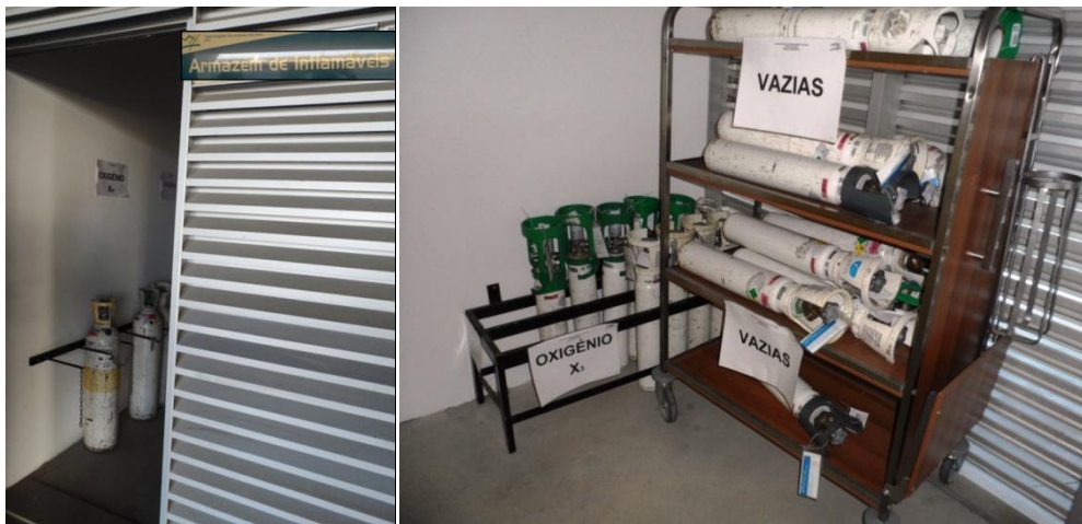
Anexo 6. Armazém de produtos inflamáveis e gases medicinais
