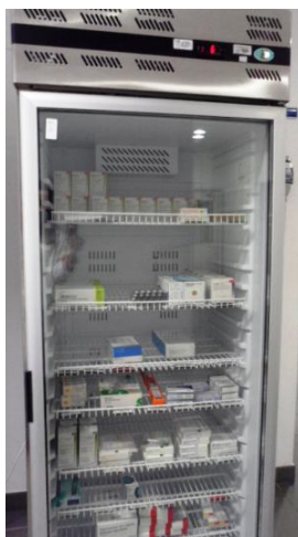
Anexo 9. Armazém de refrigeração
