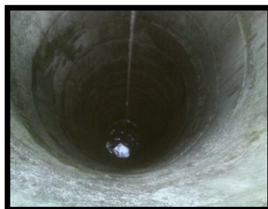
Figura 27 – Poço em Uani-Uma onde se observa o nível freático, relativamente profundo (13m). Foto: Higinio de Sousa Amaral (dia 12 de Julho de 2015).
