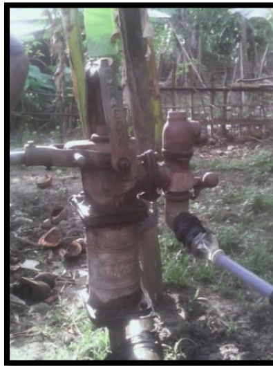
Figura 24 – Captação de água em furo com uma bomba manual instalada. Foto: Higinio de Sousa Amaral (dia 17 de Julho de 2015).
