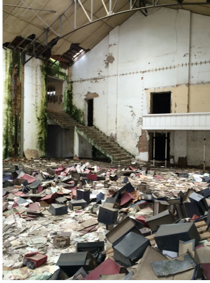
22- pormenor de acesso entre naves e varandim de acesso ao volume A
