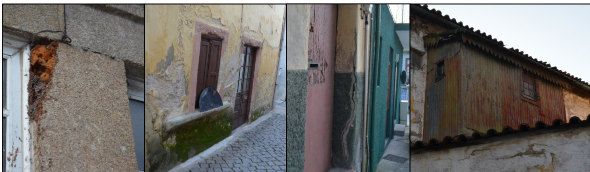
Fig. 36 – Tipos de degradação de revestimentos exteriores existentes em edifícios de Penafiel.
