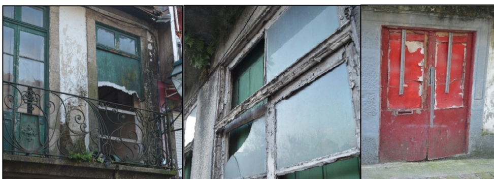
Fig. 27 – Exemplo de janelas e portas em risco de queda (Penafiel).
