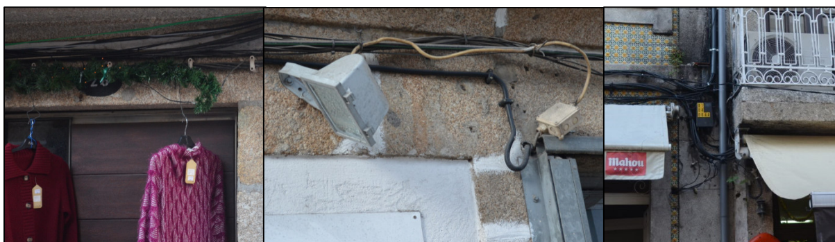
Fig. 34 – Comportamentos de risco (Esquerda e Centro). Local onde já ocorreu uma descarga elétrica devido à má condição dos cabos (Direita).
