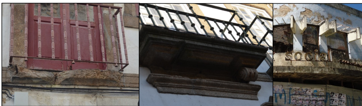
Fig. 24 – Queda de elementos em consola: Queda integral de uma varanda em Penafiel (esquerda), Queda de um cachorro em Penafiel e Queda parcial de palas em Huambo (direita). Fonte: [60]
