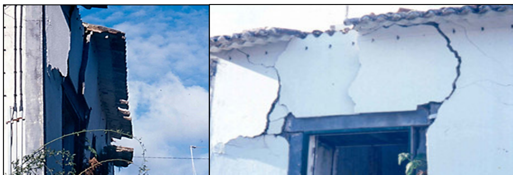
Fig. 21 – Mecanismos de colapso observados em edifícios situados nos Açores. Fonte [58]
