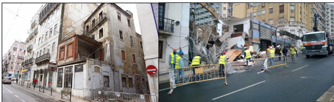
Fig. 2 – Vista geral do edifício antes e depois da derrocada. Fonte: [6].
