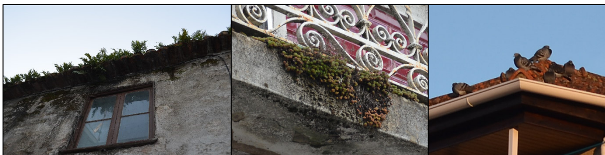
Fig. 37 – Tipos de colonização biológica existentes em edifícios de Penafiel.
