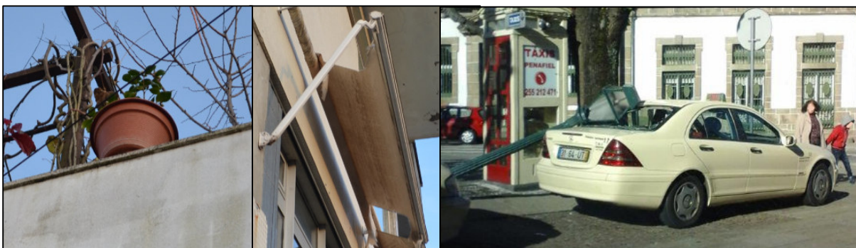
Fig. 26 – Exemplos de risco de queda de objetos de adorno (Esquerda e Centro). Queda de uma luminária (Direita).
