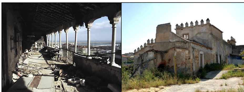
Fig. 3 – Estado de degradação do Palácio de Valflores. Fonte: [8].
