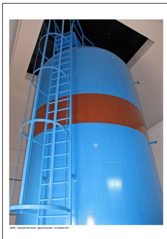
Figura 33 - RAC Instalado na Estação Elevatória (Fotografia do Prof. Francisco Piqueiro)
