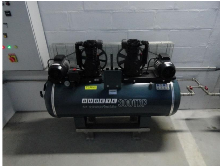
Figura 34 - Um dos Compressores Instalados
