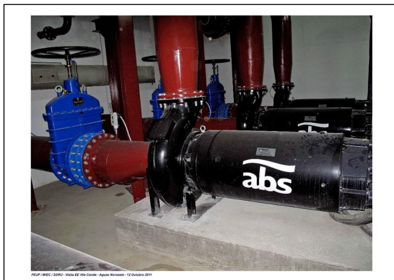
Figura 24 - Grupos Elevatórios Instalados (Fotografia do Prof. Francisco Piqueiro)
