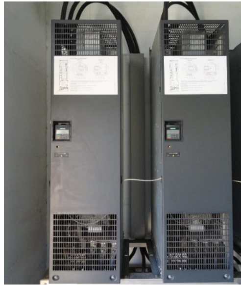
Figura 25 - Dois dos Quatro Variadores de Frequência Existentes
