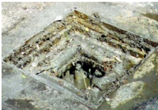
Fig.6.54 - Skimmer Box após retirada da grelha [30]
