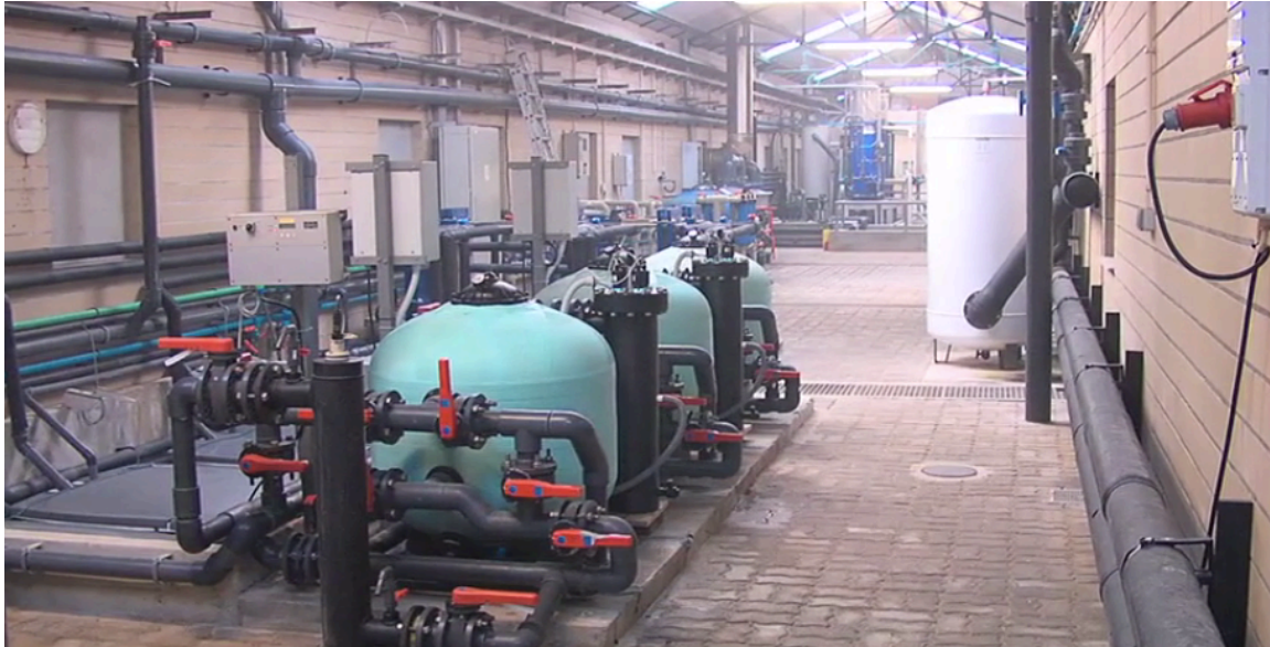
Figura 8: Zona das máquinas da sala dos reprodutores. Pode-se observar os reservatórios, os filtros de areia e a desinfecção por filtros de luz UV (Sea8, 2015).
