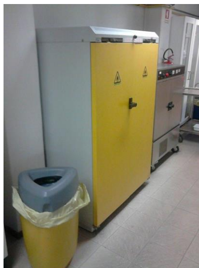
Figura 10- Armário corta-fogo produtos químicos líquidos
