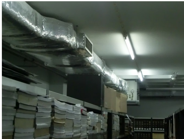
Fig. C.10.1 – Sistema de climatização do depósito fechado.
