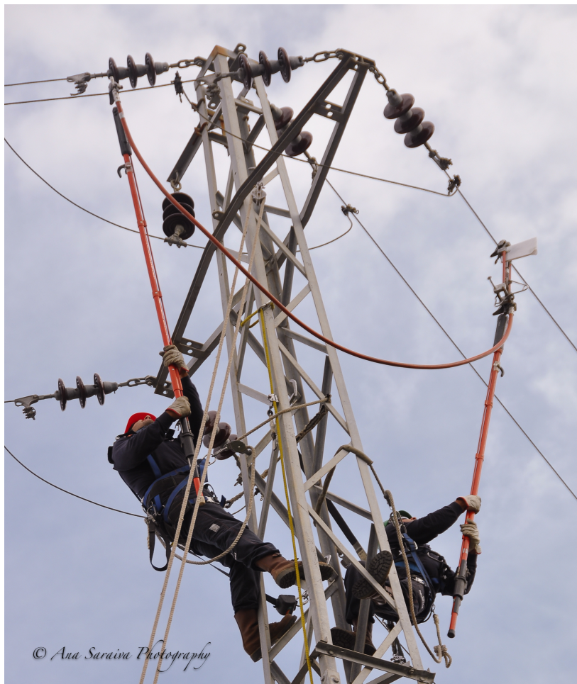
Figura 7.4: Ligação de um arco em TET em AT (Empresa “A”, 2015)
