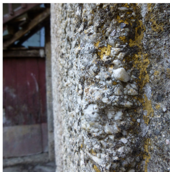
arenização da alvenaria
