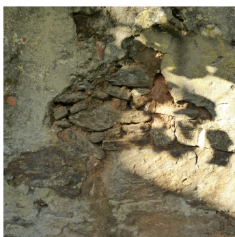
destacamento do reboco
