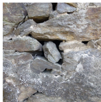
ausência de argamassa de ligação
