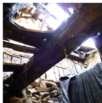
degradação da cobertura
