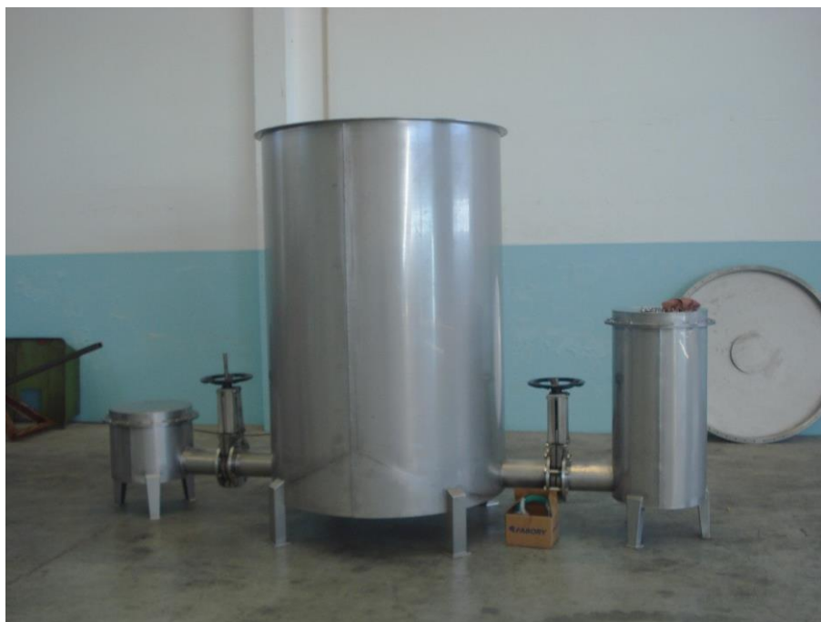
Figura 7.11 - Vista geral do reactor.
