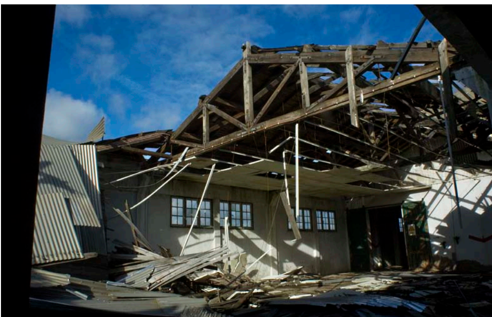
203. Degradação do armazém central
