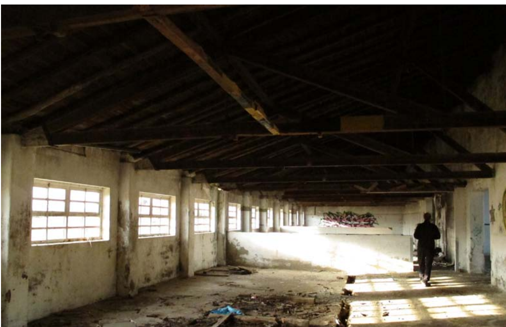
117. Degradação da cobertura do armazém a Norte. Armazém de lavagem do bacalhau
