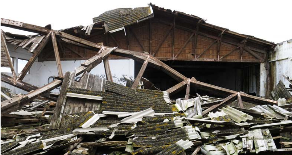
195. Degradação da Cobertura da nave 3
