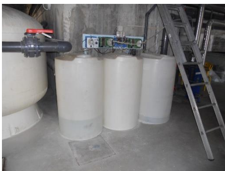
Figura 5.6 – Posto de doseamento de desinfetante e corretor de pH
