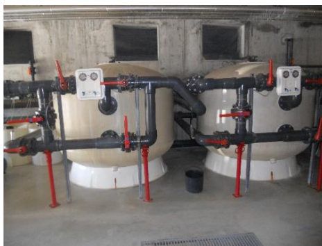
Figura 5.5 – Unidades de filtros de areia com funcionamento automático
