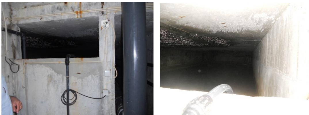
Figura 5.7 – Janela de acesso ao tanque de compensação das piscinas exteriores
