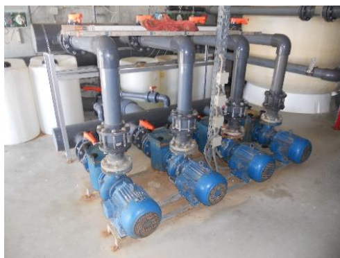
Figura 5.8 – Sistema de bombagem das piscinas exteriores
