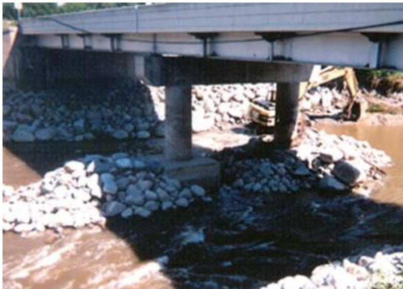
Figura 5 - Proteção em riprap sem escavação do fundo nos pilares da ponte [22]
