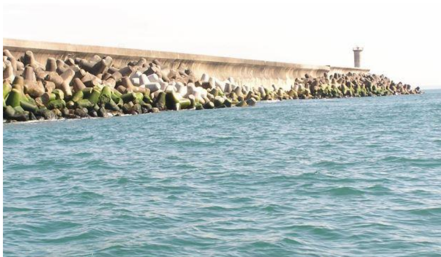
Figura 4-10 – Exemplo de trechos mais danificados no manto resistente (arquivo APDL, 2009).
