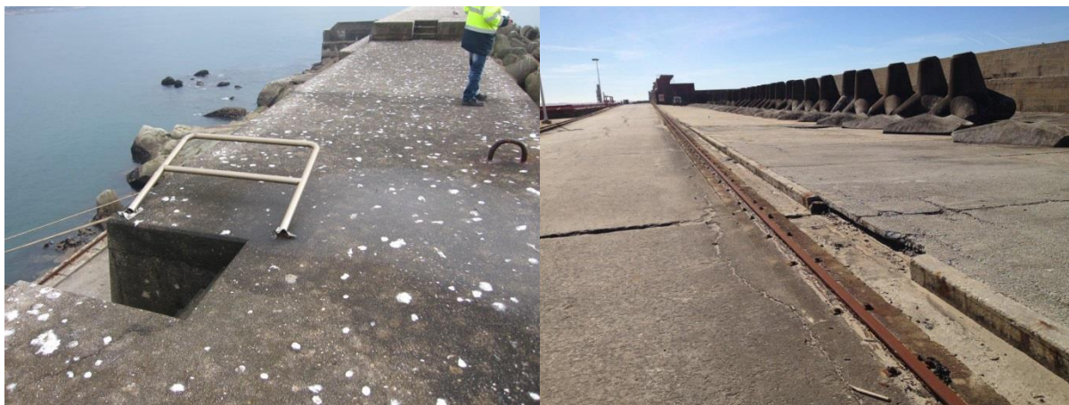
Figura 4-15 – Guardas das escadas (esquerda), e carris de rolamentos (direita) (2015).
