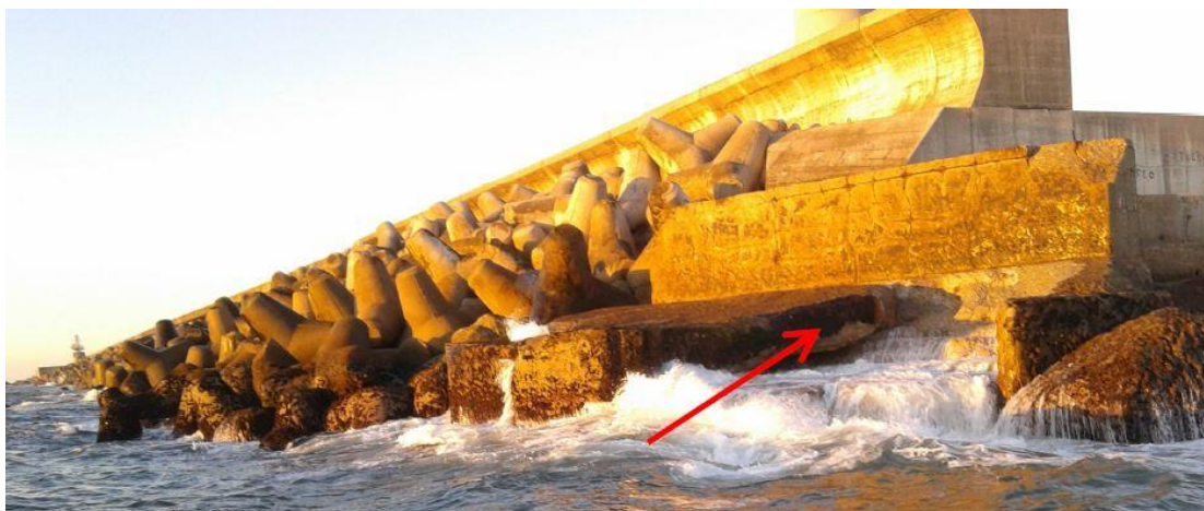
Figura F – Danos no patamar inferior (APDL, 2012).
