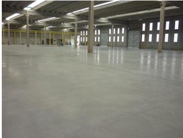
Fig. 2.10 – Pavimento com endurecedor de superfície [32].
