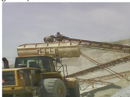
Figura 17 – Risco n.º 9 e 10
