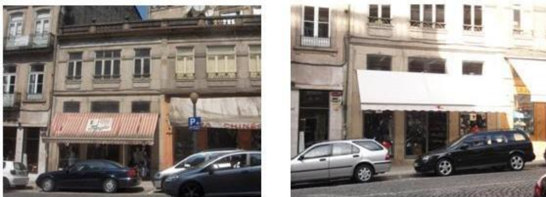
Figura 4. Toldo em mau e em bom estado de conservação (Vide www.portovivosru.pt )
