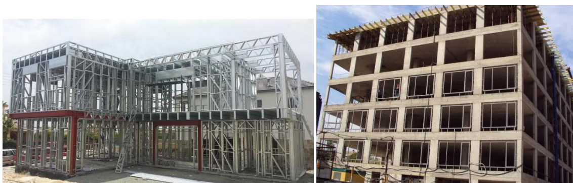
Fig.16 – Sistemas estruturais em pórtico: Fig. 16a) – Pórticos metálicos Pelagos Homes ; Fig. 16b) – Pórticos em betão armado da Dania Cebus ;
