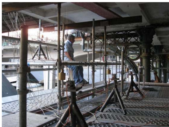
Figura 4.50 – Suportes dos transdutores.
