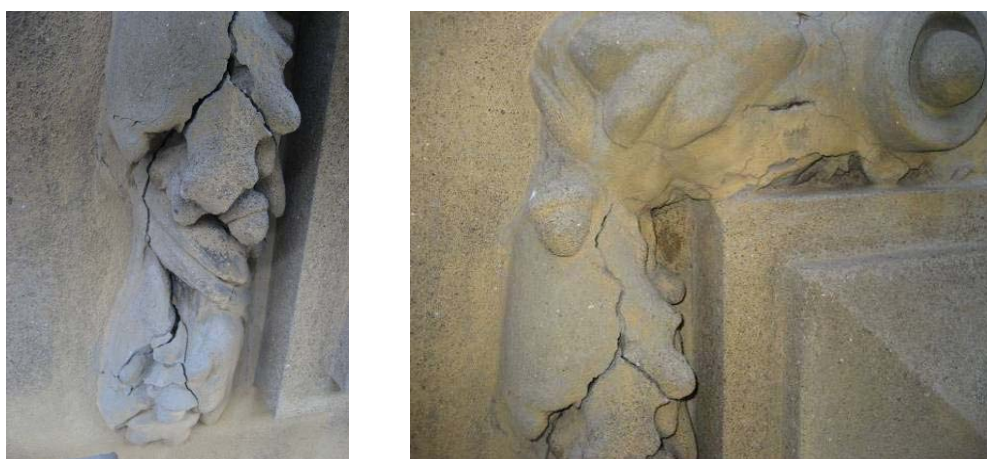
Figura 5.34 – Fissuração/fratura nos elementos decorativos vegetalistas.
