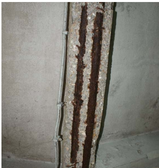
Figura 4.25 – Destacamento do betão de recobrimento e corrosão de armaduras numa viga da caixa de escadas, com uma redução da secção do aço considerável.
