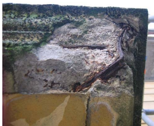
Figura 5.28 – Pormenor de armaduras do beiral e presença de musgos.
