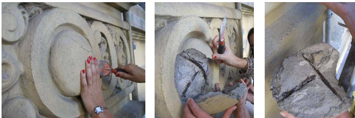
Figura 5.29 – Destacamento de argamassa fissurada com auxílio de espátula. Carbonatação das argamassas e corrosão de armaduras.
