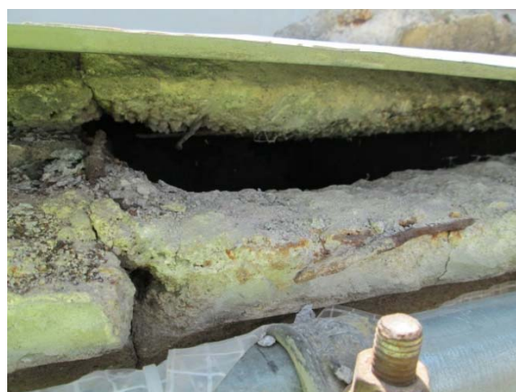
Figura 5.21 – Cornija fingida (oca no interior).
