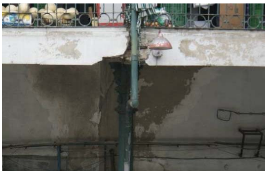
Figura 4.19 – Destacamento do betão de recobrimento e corrosão de armaduras numa viga V1 da galeria.
