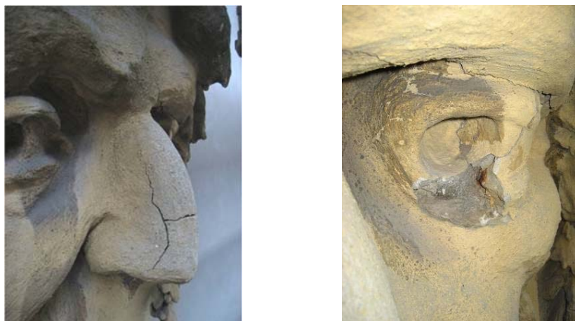
Figura 5.33 – Fissuração e destacamento de argamassas por corrosão de armaduras em elementos figurativos (caras).
