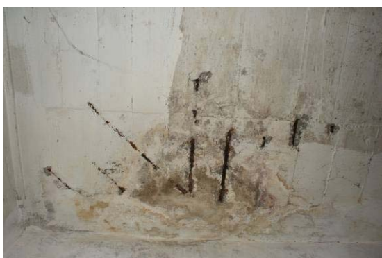
Figura 4.28 – Destacamento do betão de recobrimento e corrosão de armaduras num painel de laje em abóbada, sob a Rua de Sá da Bandeira.
