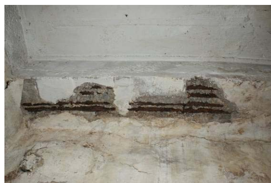
Figura 4.29 – Destacamento do betão de recobrimento e corrosão de armaduras no arco A2, sob a Rua de Sá da Bandeira.
