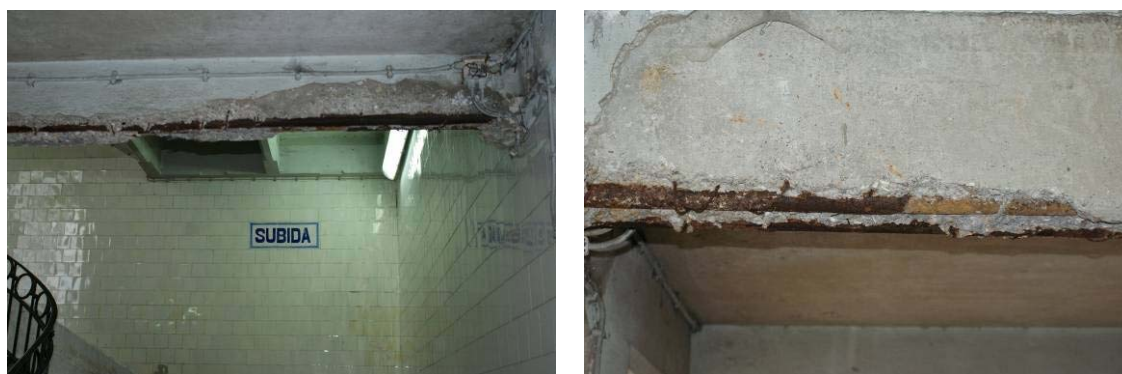
Figura 4.24 – Destacamento do betão de recobrimento e corrosão de armaduras numa viga da caixa de escadas.
