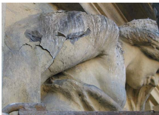
Figura 5.18 – Elemento figurativo com varões metálicos e destacamento de argamassa.
