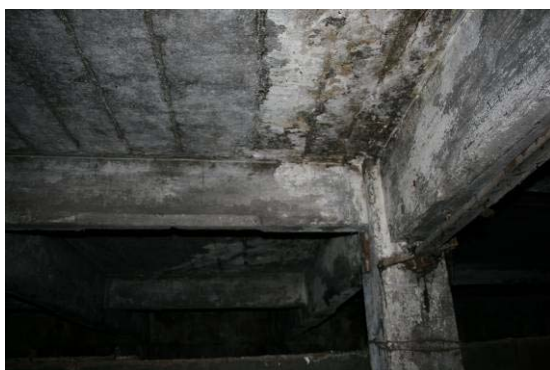
Figura 4.35 – Presença de humidade na zona do antigo matadouro.
