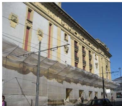
b) Fachada lateral direita parcialmente entaipada
