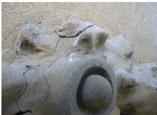
Figura 5.25 – Fratura e desprendimento dos elementos decorativos.
