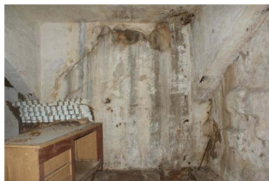
Figura 4.36 – Presença de humidade na galeria sob a Rua de Sá da Bandeira.
