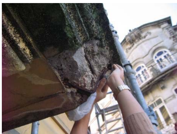
Figura 5.27 – Destacamento da camada de argamassa e corrosão de armadura em beiral.
