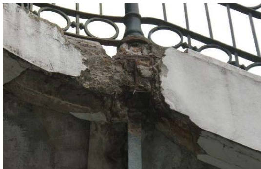
Figura 4.20 – Destacamento do betão de recobrimento e corrosão de elementos metálicos numa viga V21 da galeria.
