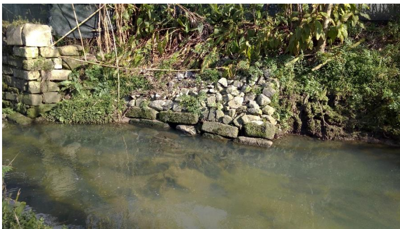
Figura 31- Enrocamento Vivo danificado.
