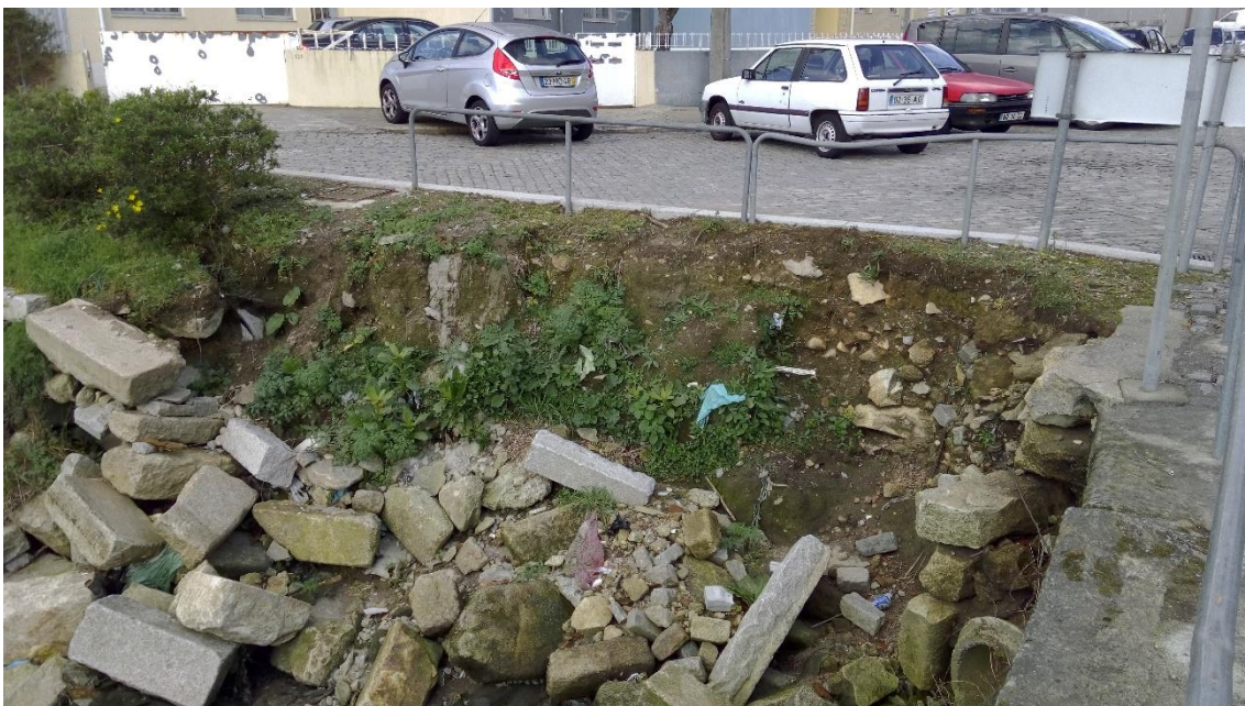
Figura 39 Enrocamento danificado 3ª fase.
